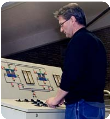
Borås VA och Novotek arbetade fram en framtids säker lösning som tar vara på befintlig utrustning och erfarenhet.
